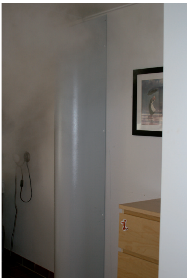
Oscars gate 15: Vanntåkeanlegget installert og utløst.
